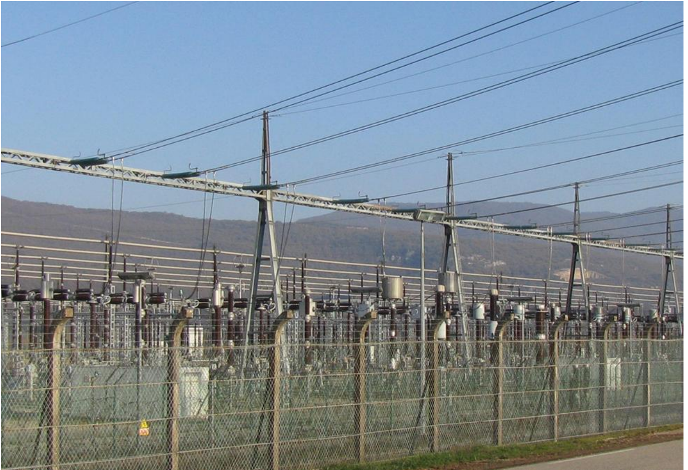
Poste d'interconnexion de Creys Malville. Département de l'Isère (France). Photo. J-MT
